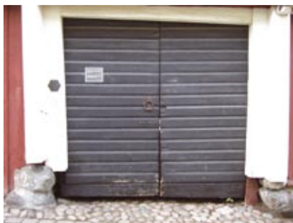
Port med smitt dörrhandtag mot Arendt Byggmästaresgata
